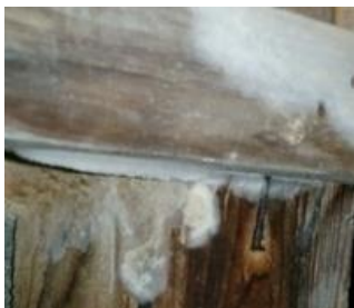
カビだらけでボロボロの土台
