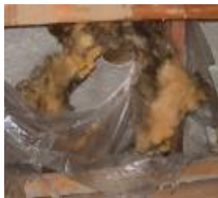
カビだらけの断熱材グラスウール
